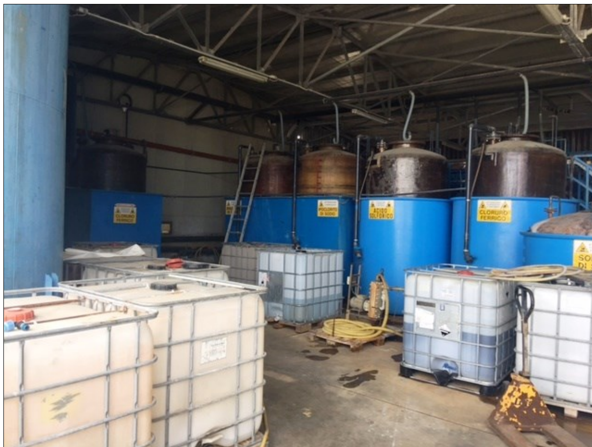
Figura 7.3.1 – Particolare stoccaggio miscele pericolose all'interno delle aree di trattamento.
