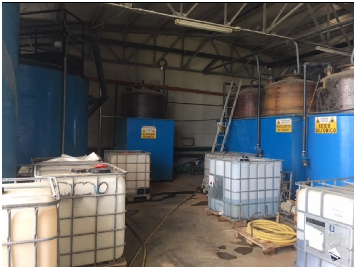
Figura 7.3.2 - Serbatoi stoccaggio reagenti con bacino di contenimento.
