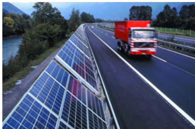
Figura 4: esempio di installazione fotovoltaica su bordo stradale lungo l'autostrada A13 in Svizzera; fonte 5
